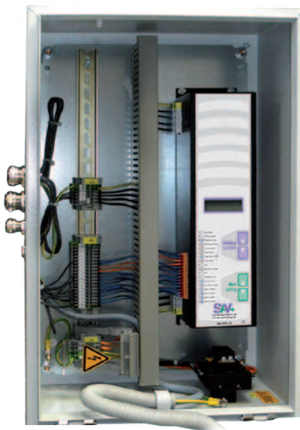
Steuerung im Schaltkasten
